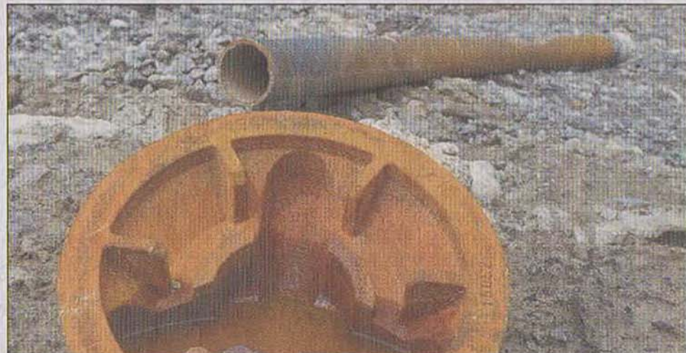
Pfahlgründung in der Muthstraße: Eine Ramme (oben) drückt mit Schneidköpfen versehene Eisengussrohre (unten) in den Boden und verfüllt sie mit Beton. Fotos: Tim Kegel
